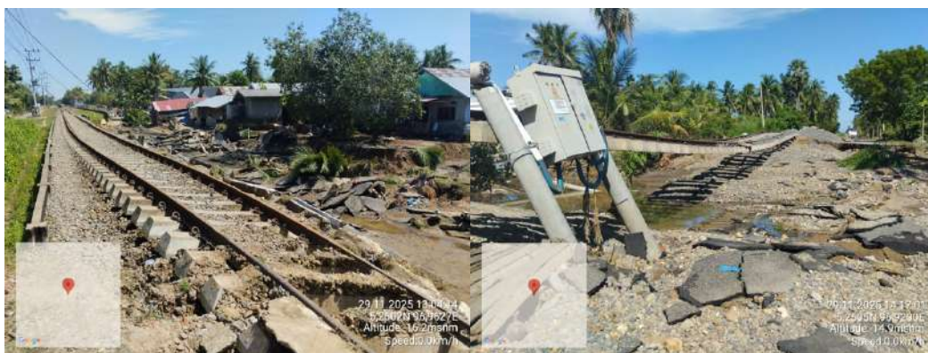
Gambar 2. 2 Kondisi Prasarana Perkeretaapian Kota Lhokseumawe Pasca Bencana Banjir
